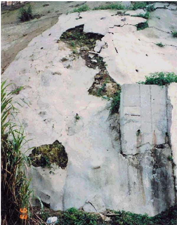
(3) 破裂灰泥護面
