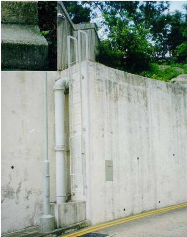
(1) 鋪設在擋土牆外的帶水管道
