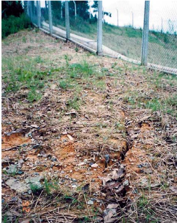
(1) 斜坡上張力裂縫
