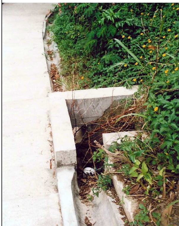
(3) 坡腳的集水井
