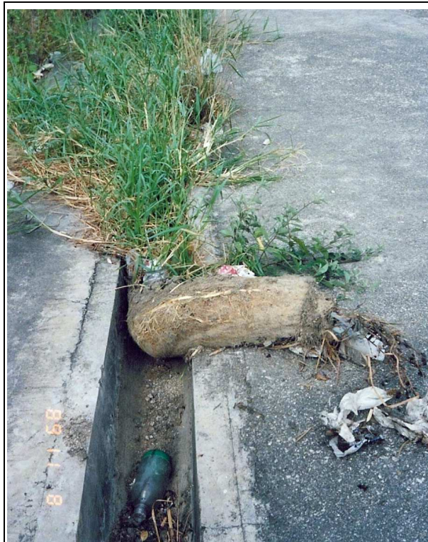
(1) 坡頂的 U 形排水渠
