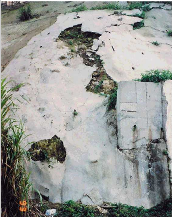
(3) 破裂灰泥護面
