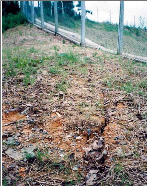
(1) 斜坡上張力裂縫
