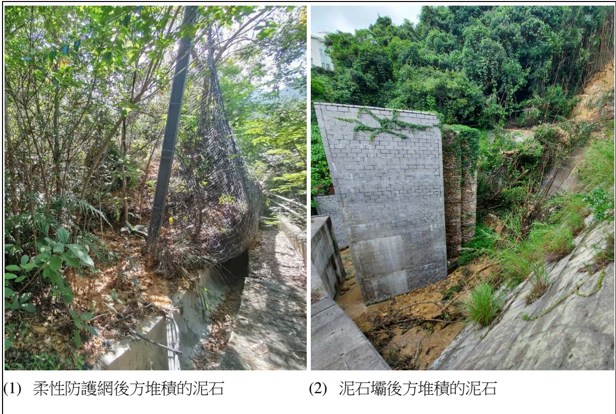
圖片 7.1 防禦措施後方堆積泥石
