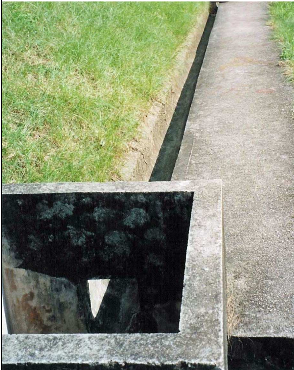
(3) U 形排水渠及集水井
