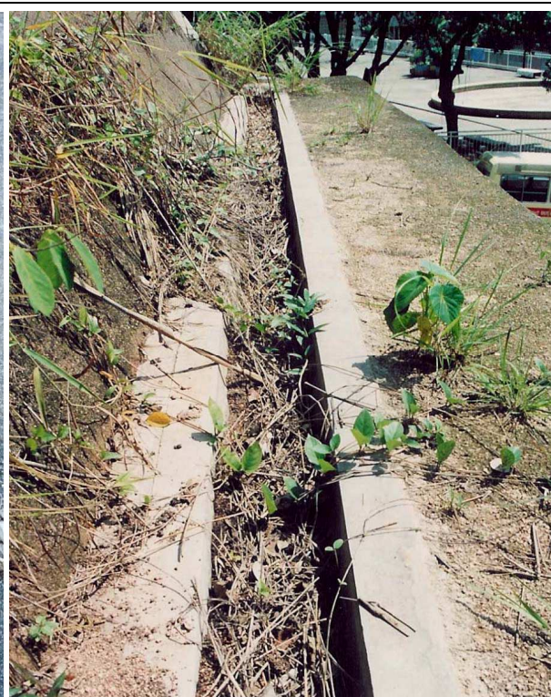
(2) 坡級上的 U 形排水渠
