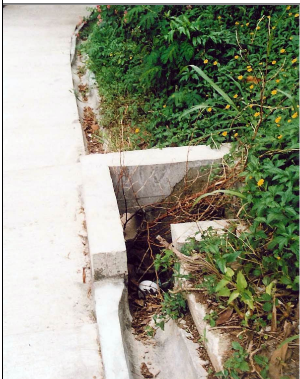
(3) 坡腳的集水井
