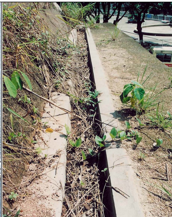
(2) 坡級上的 U 形排水渠
