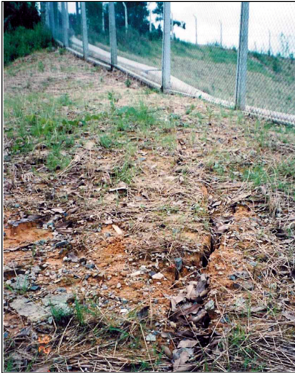
(1) 斜坡上張力裂縫
