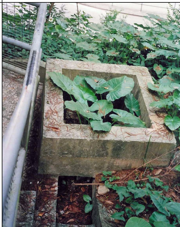
(4) 坡頂的集水井
