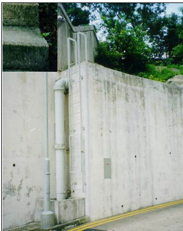
(1) 鋪設在擋土牆外的帶水管道
