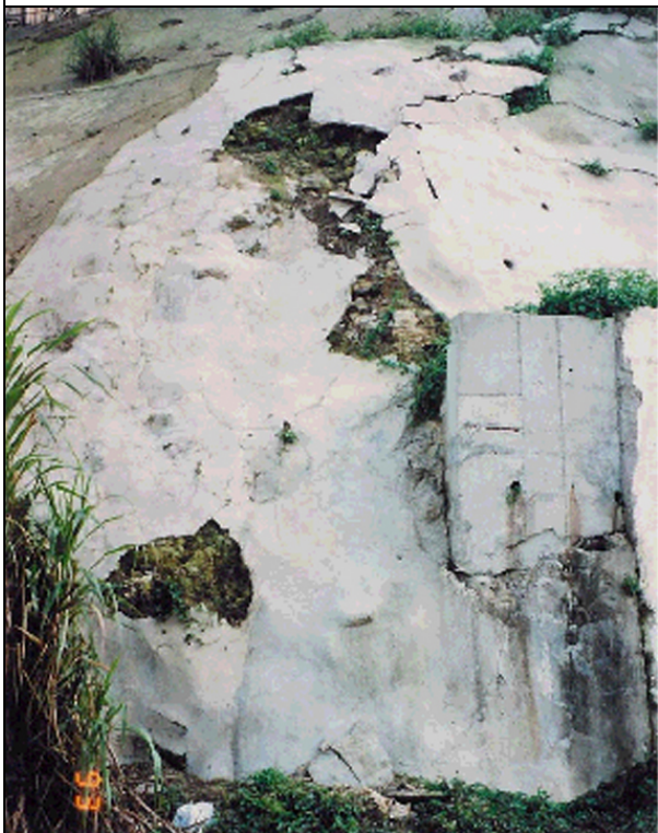
(3) 破裂灰泥護面
