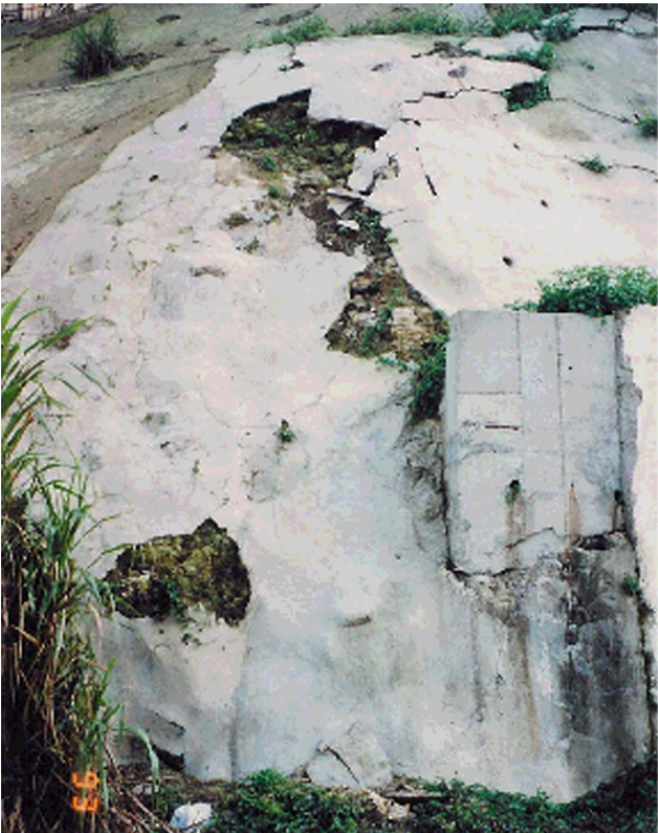
(3) 破裂灰泥護面
