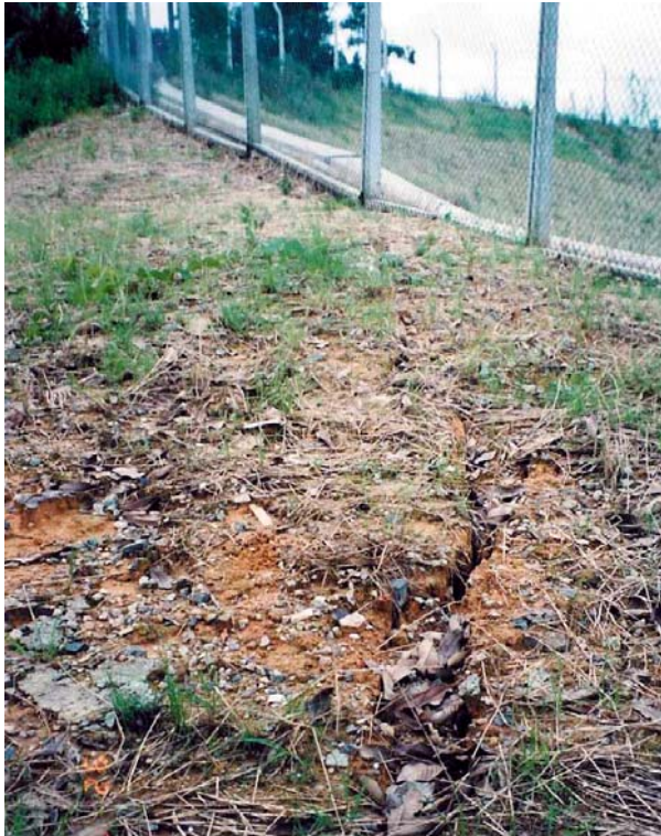
(1) 斜坡上張力裂縫
