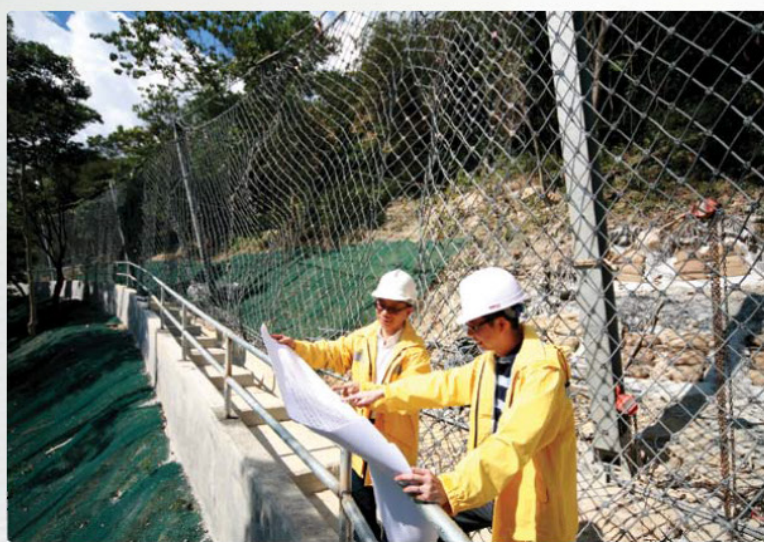
土力工程師正視察在長遠防治山泥傾瀉計劃下建造的柔性屏障
