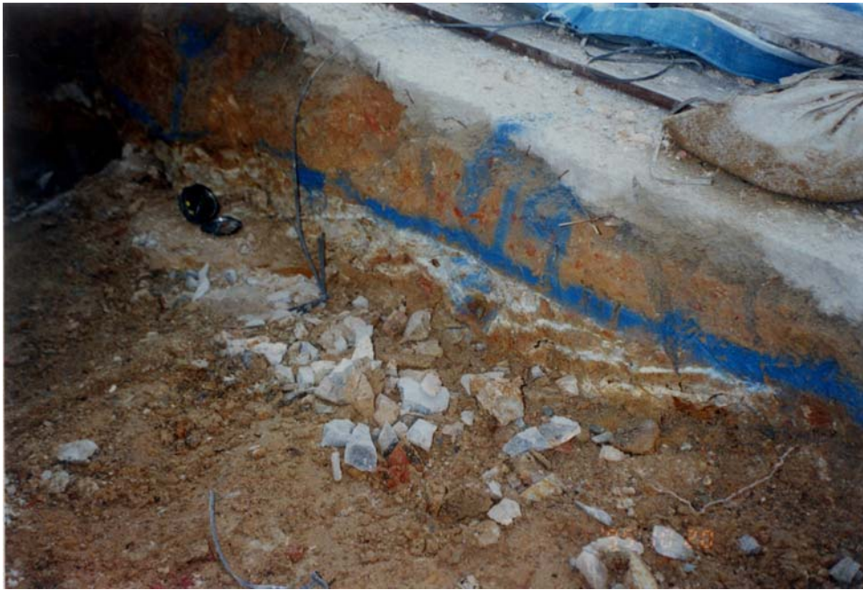
照片12 - 於山泥傾瀉西面，崩塌殘痕最前端，含豐富高嶺石的蝕變凝灰岩剩餘部份 (一九九五年十月二十日拍攝。其位置見圖21)
