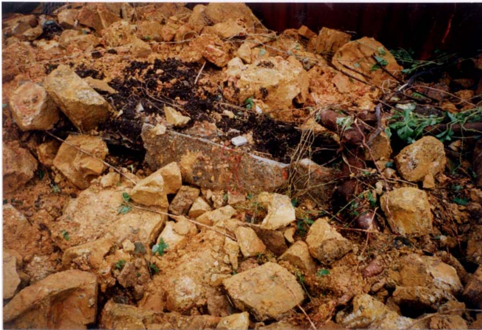
照片5 - 山泥傾瀉泥石中的淤塞地面排水渠 (一九九五年八月十三日拍攝。其位置見圖21)
