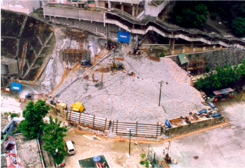
照片M8 - 於緊急修補工程完成後及進行場地勘探時，山泥傾瀉現場的景象。 (照片攝於一九九四年八月十三日)
