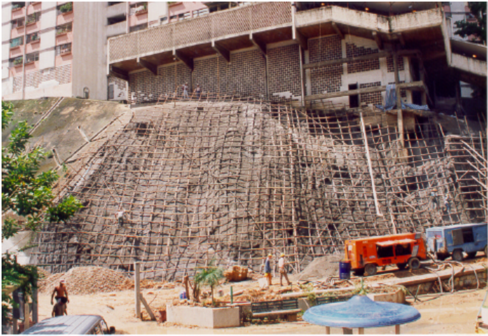
照片M7 - 於一九九四年七月二十九日斜坡噴上混凝土後，山泥傾瀉現場的景象。
