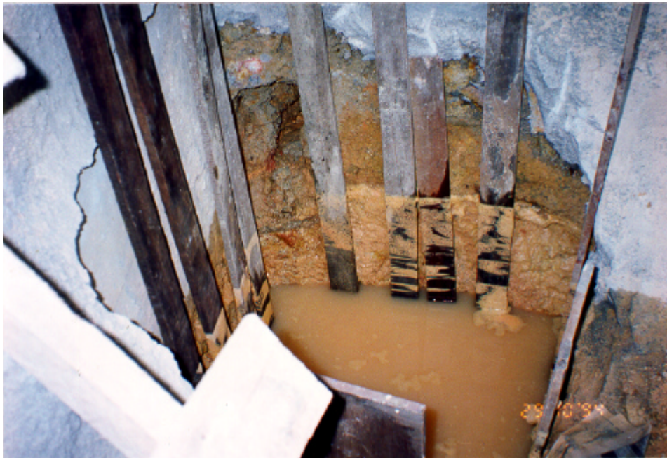
照片M17 - 在D座底部進行滲流試驗時,於崩塌殘痕頂部流進 編號TP26探井的地下滲流。 (照片攝於一九九四年十月二十九日)
