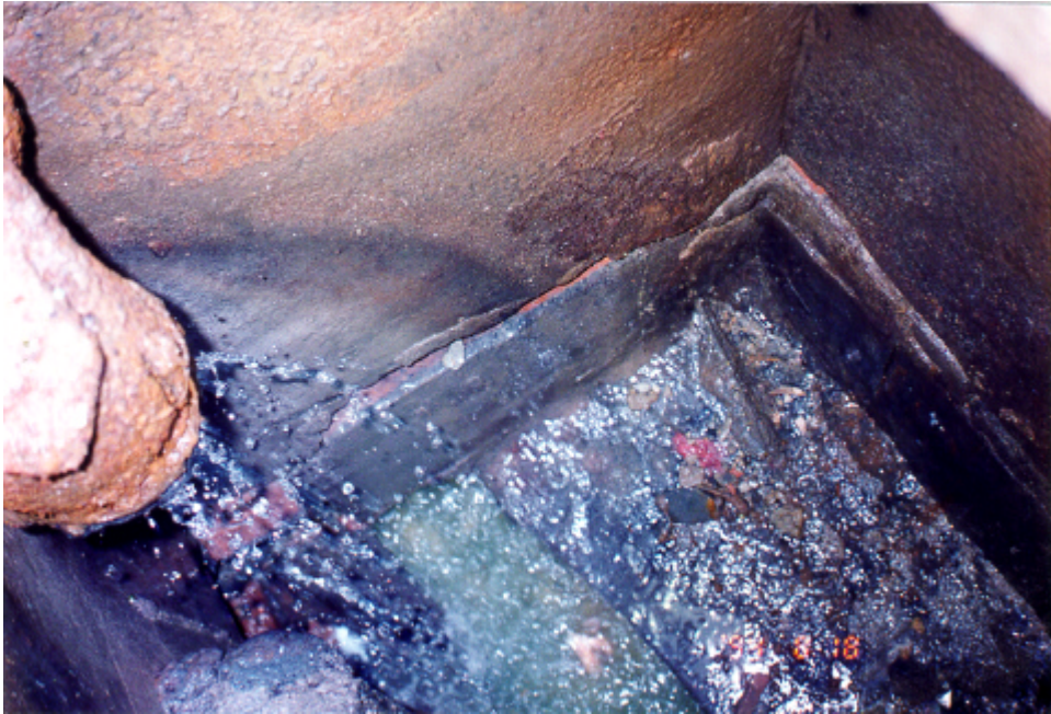
照片M12 - 近編號34污水砂井底部有一條裂縫。 (照片攝於一九九四年八月十八日)
