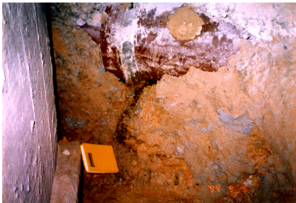
照片M11 - 在編號77砂井與崩塌殘痕之間，出現輕微滲漏的污水管部份。(照片攝於一九九四年九月五日)
