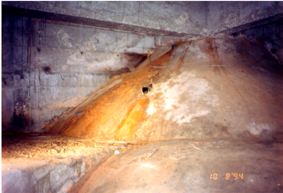
照片M14 - 於挖掘編號TP35探井前，在D座底部鄰近院子範圍的地面， 疏水孔有滲水跡象。 (照片攝於一九九四年八月十日)
