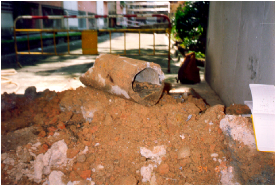
照片M13 - 在院子範圍內，編號GT15a集水欄柵與 編號15砂井之間的損毀雨水管部份。 (照片攝於一九九四年八月二十三日)
