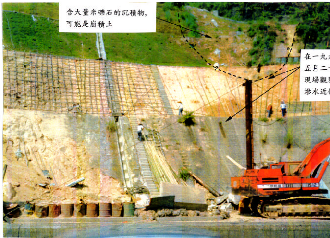
照片11 - 照片顯示編號 11NW-A/C55 削土坡中部在山泥傾瀉防止工程進行中的現場景象 (一九九一年十月四日拍攝)
