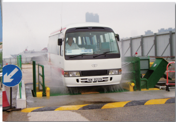
環境管理計劃 — 工地出口的自動車輪清洗系統 Environmental Management Plan – Automatic wheel-washing facility at site exit
