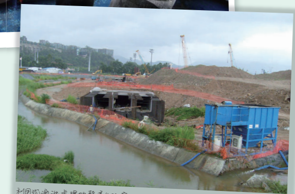
利用沉澱池處理地盤產生的廢水 Sedimentation tank to treat wastewater generated on construction site
