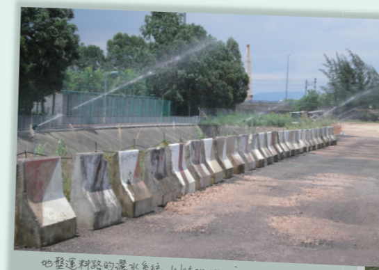
巴登運料路的灑水系統 Water spraying system on Site Haul Road
