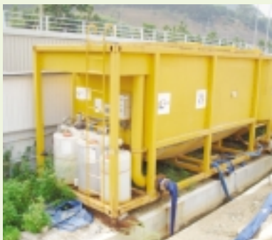
利用沉澱池處理地盤產生的廢水 Sedimentation tank to treat the wastewater generated on site
