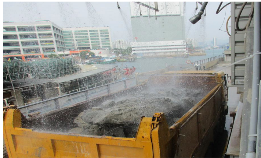
在泥頭車上噴水以減少粉塵的產生 Use Water Sprayers on Trucks to Reduce Dusty Materials
