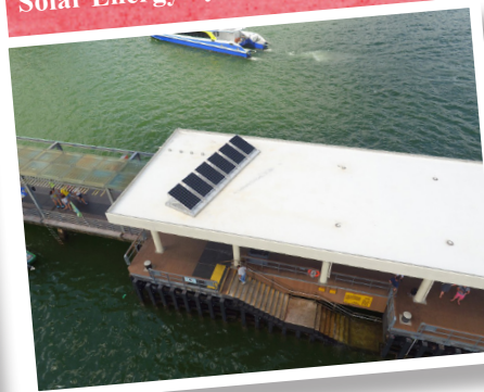
於西貢公眾碼頭的太陽能系統 Solar Energy System in Sai Kung Public Pier
