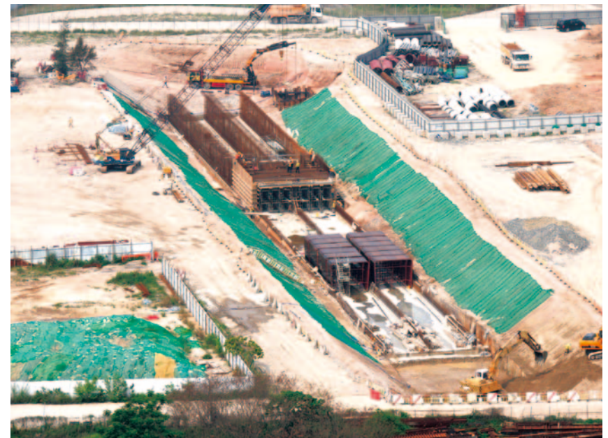
建造中的箱形暗渠B5 Construction of Box Culvert B5 in progress
