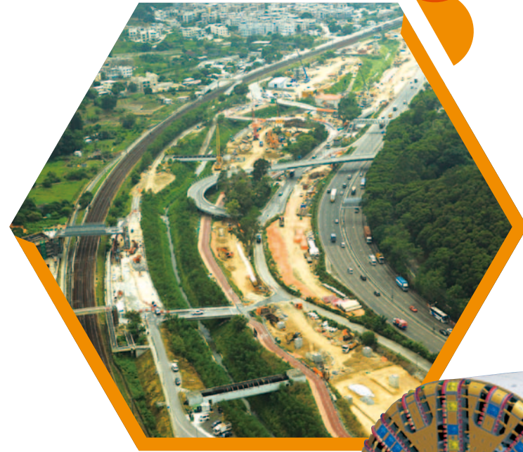
施工中的粉嶺公路交匯處工程 Construction of Fanling Highway Interchange in progress
