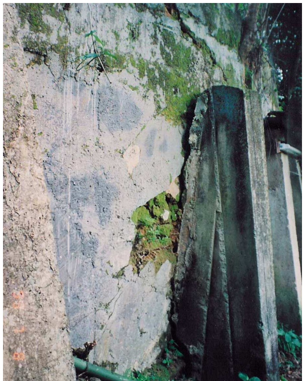
(d) Cracked Surfacing and Wall
