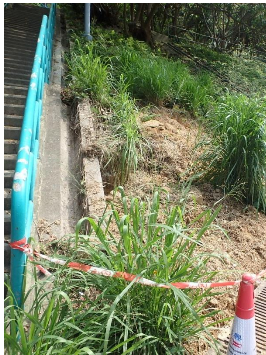
(d) Erosion Adjoining Channel with Apron of Limited Width
