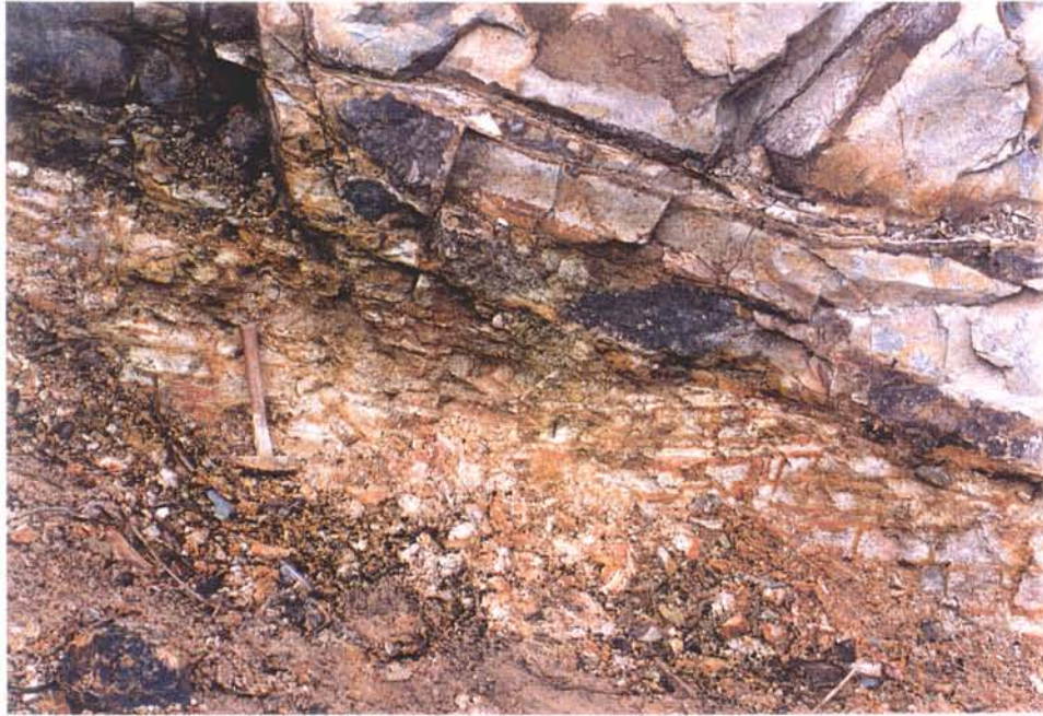
照片 10 - 於山泥傾瀉東面，未崩塌削坡內，含豐富高嶺石的蝕變凝灰岩 (一九九五年十月八日拍攝。其位置見圖 21)
