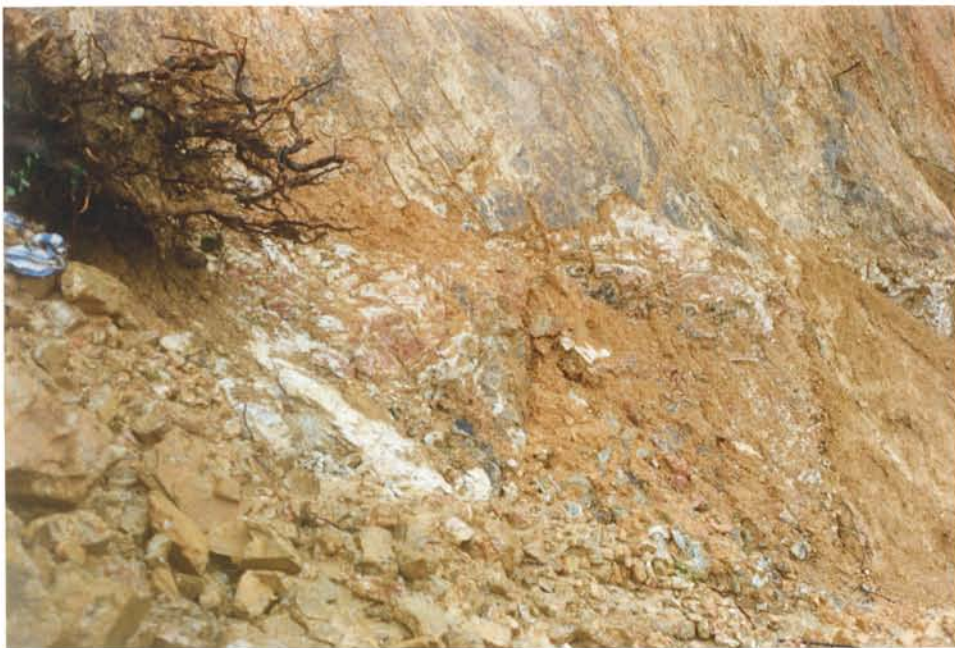
照片13 - 西面滑坡崖的「分散」岩層 (一九九五年八月十四日拍攝。其位置見圖21)
