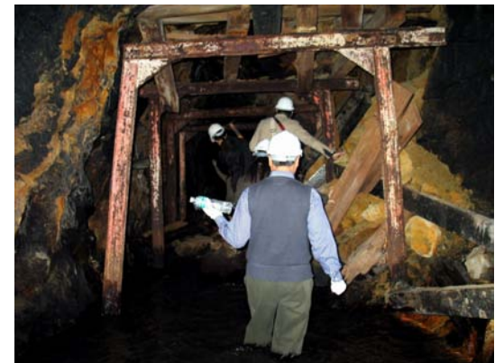
廢棄的採礦隧道內情況惡劣，非常危險
